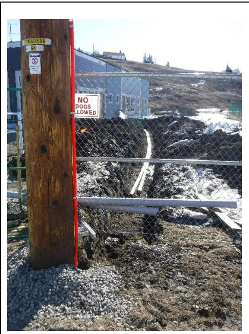
Underground Electrical Conduit
